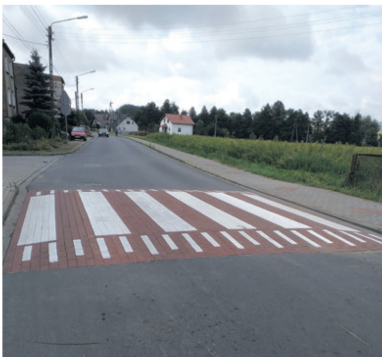
● Wyniesione przejście dla pieszych w Zbąszyniu
